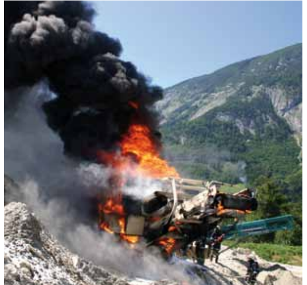
Brand des Steinbrechers auf der BEG-Baustelle
