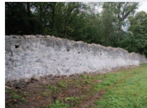
Die renovierte Tiergartenmauer
