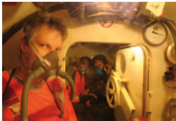
Ausschleusen von zwei Bauleuten und einem Kameraden der Berufsfeuerwehr Innsbruck beim Einsatz im BEG-Rettungsstollen
